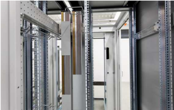
Stromschiene mit Power- und Datenbus / Racks mit ausreichend Platz zur Verkabelung
