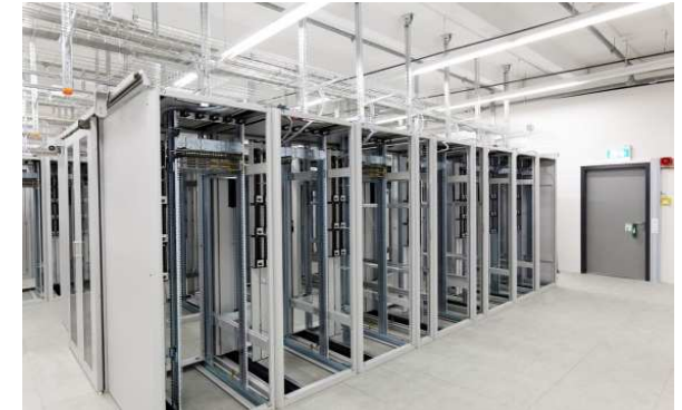
Stahldraht-Gitterrinnen kreuzungsfrei / Racks inkl. Gangabdeckung und Schiebetüren
