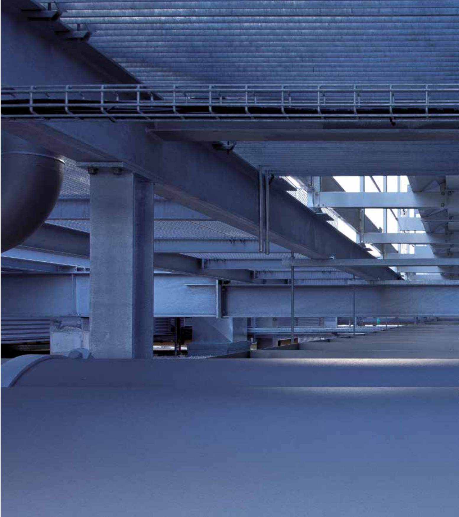
▼ Unteransicht des Technikrostes der Rückkühler
